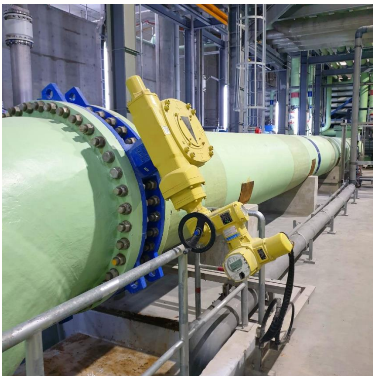
In der Keppel Marina East Desalination Plant in Singapur sind 156 AUMA Stellantriebe über alle Aufbereitungsstufen hinweg im Einsatz. Quelle: AUMA
